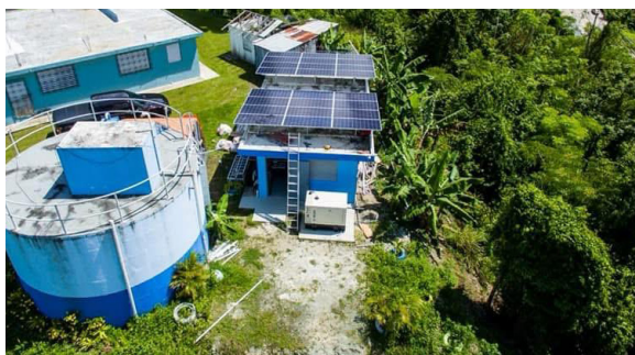
Vista del sistema de energía para la resiliencia del Acueducto Rural Pedro Calixto, Inc. del barrio Borinquen de Caguas.
