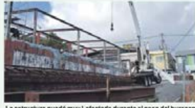
La estructura quedó muy afectada durante el paso del huracán María, por lo que se hizo necesaria su demolición para dar paso a la construcción de unas nuevas facilidades.
