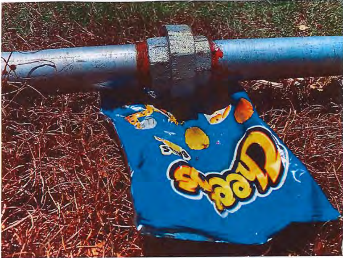
Unión (" fitting ") de metal de donde ocurre el liqueo.
