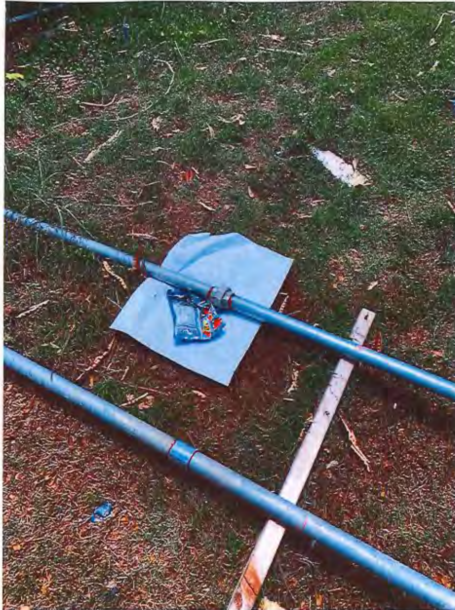
Almohadilla absorbente conteniendo el liqueo de diésel.
