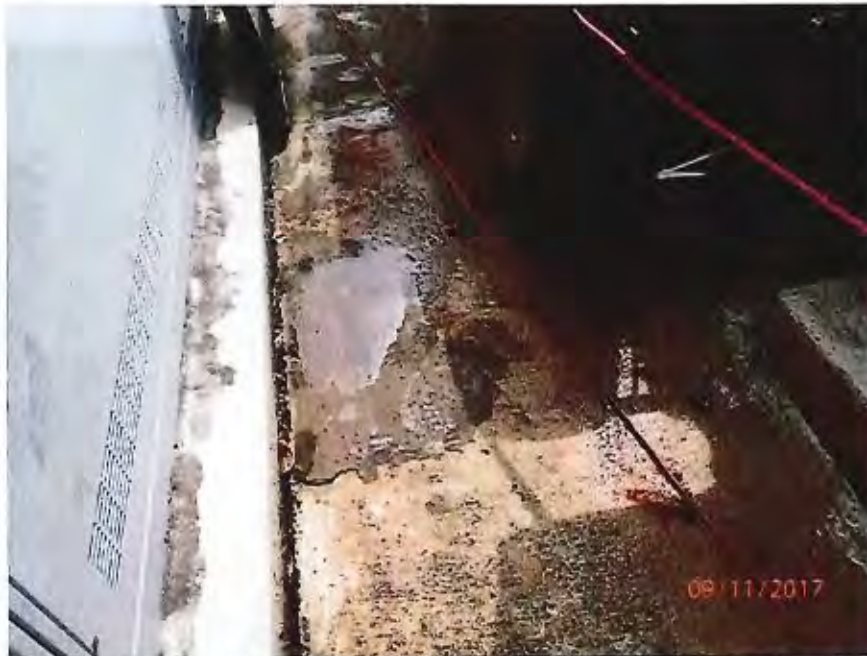
Figura 1. Derrame de diésel que proviene del generador de emergencias de 500 galones.
