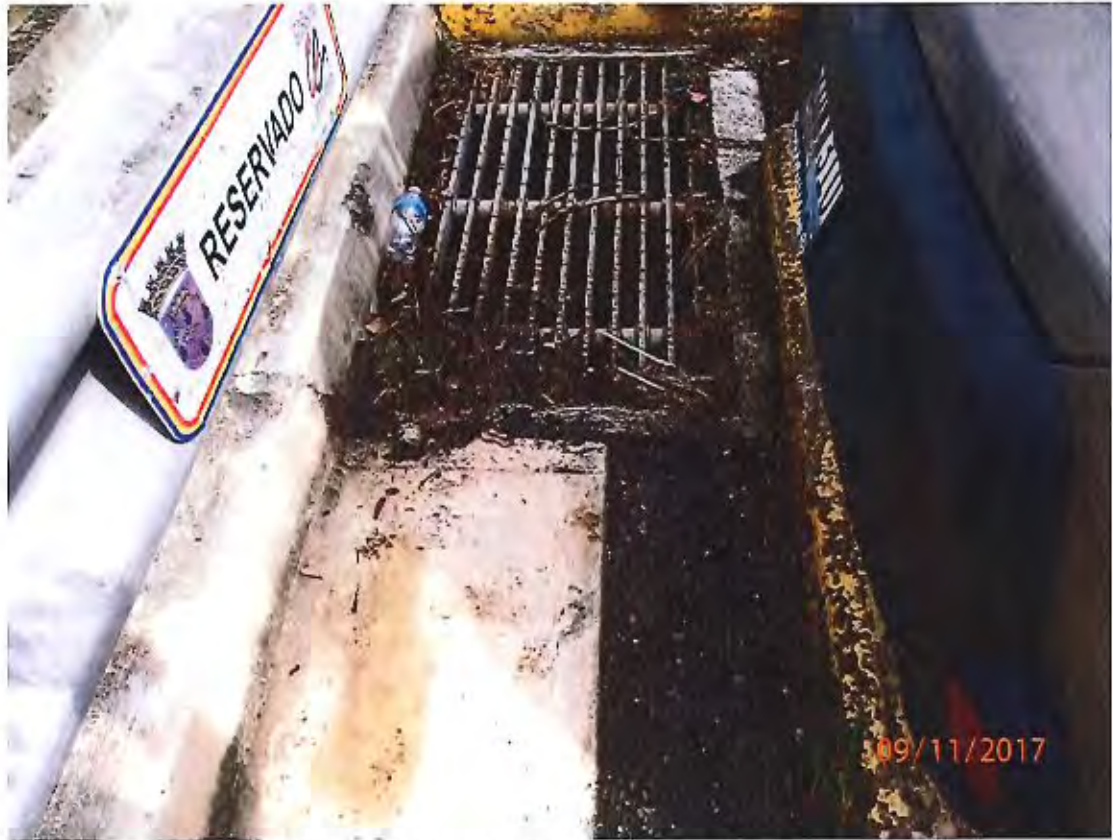
Figura 3. Drenaje pluvial ubicado en el estacionamiento donde paso el diésel derramado.
