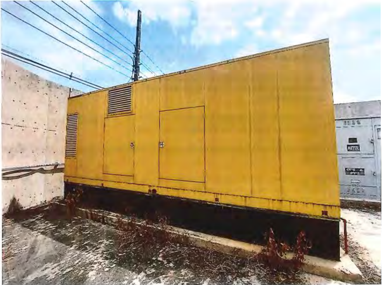
Figure 12. Generador de emergencias con tanque autocontenido de 500 galones.
