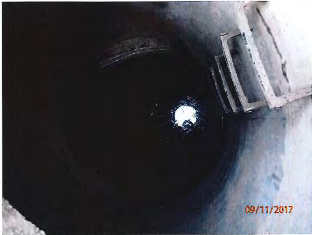
Figure 4. Sistema de drenaje pluvial con rastro de diésel.
