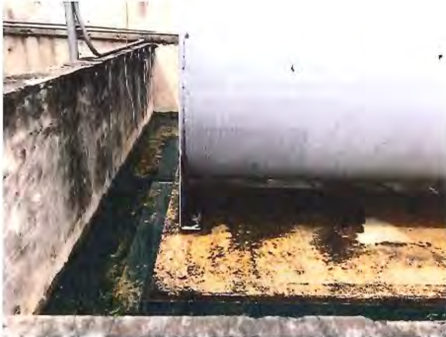
Figura 8. El tanque principal tenía fuga de diésel y el dique evito que el diésel derramado llegara al sistema pluvial.
