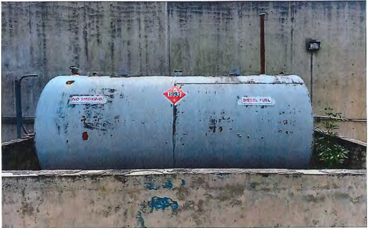
Figura 10. Tanques sobre terreno de diésel de 2,000 galones.
