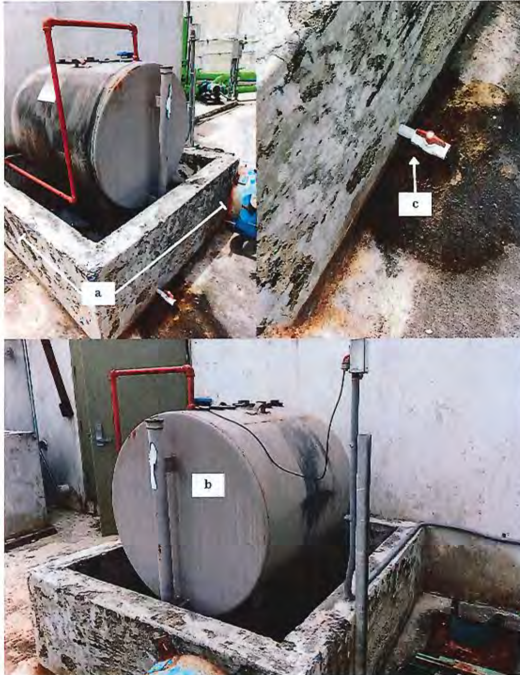
a) Dique que evita derrames de diésel. b) Tanque sobre terreno de diésel de 250 galones. c) Válvula ubicada en el dique del tanque aéreo de 250 galones.
