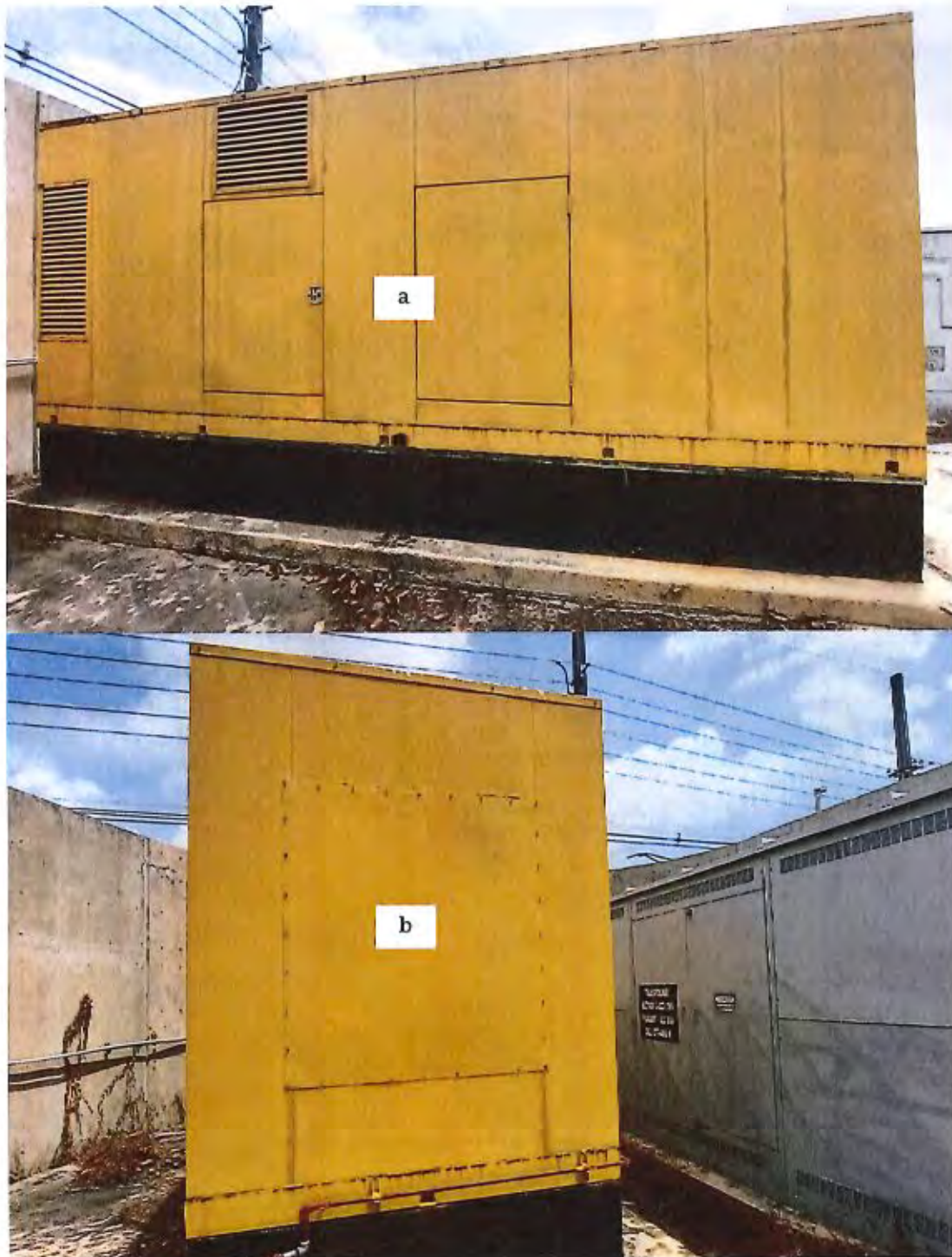
a y b) Generador de emergencia con tanque autocontenido de 500 galones.
