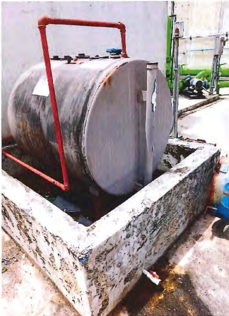
Figura 11. Tanque sobre terreno de 250 galones
