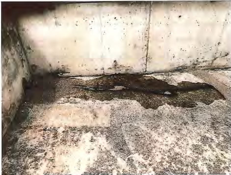
Figura 9. El personal de mantenimiento de la Nueva Casa Alcaldía cerró la válvula por completo y el diésel que llegó al suelo fue controlado mediante el uso del equipo de derrame en el área
