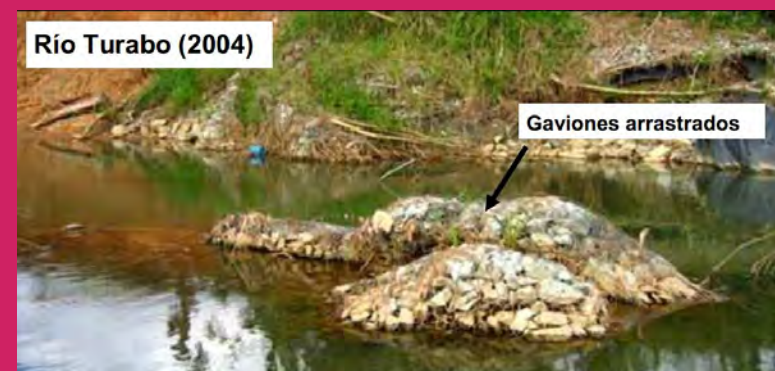
Gaviones arrastrados por la fuerza del río
