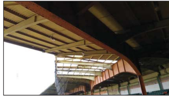
AREAS DE PLANCHAS INEXISTENTES O DAÑADAS
