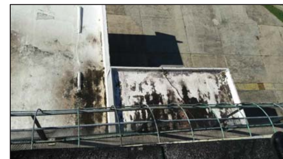
TECHO ENTRADA PRINCIPAL CON TRATAMIENTO FLEX A SER LAVADO Y REACONDICIONADO
