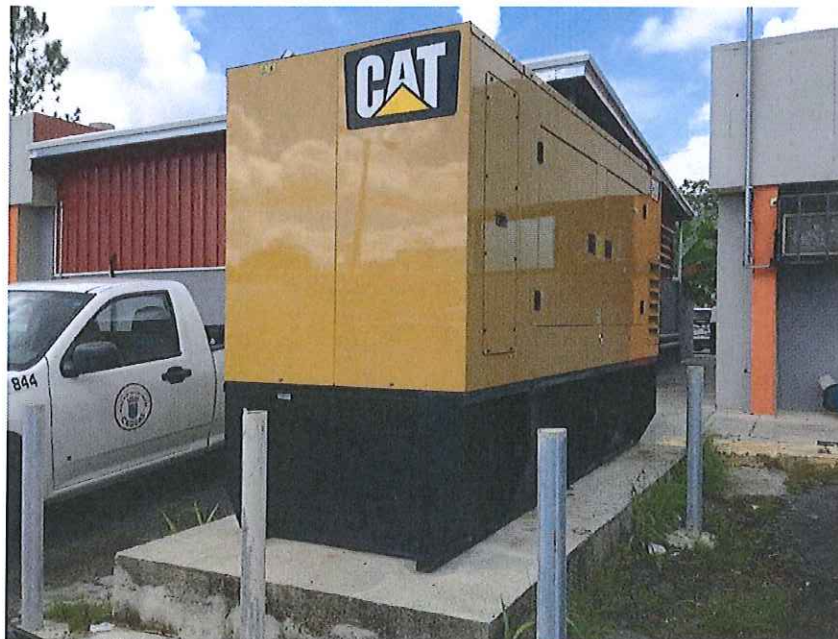
Figura 4 Generador de emergencia con tanque de diesel autocontenido – Conservación de Edificios
