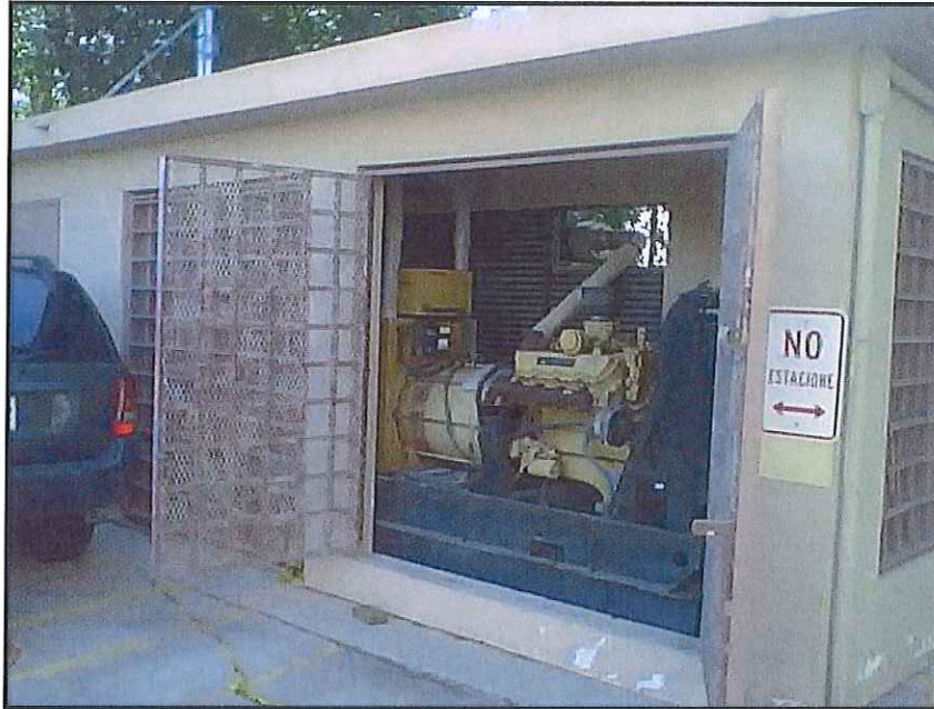
Figura 3 Generador de emergencia con tanque de diesel autocontenido - Secretaría
