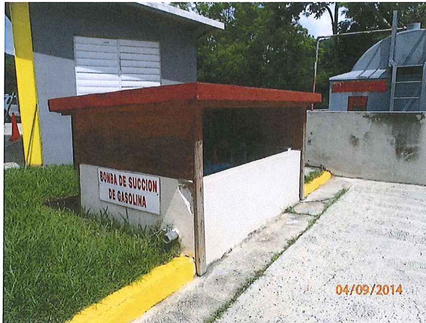
Figura 5 Área de contención para llenado de gasolina/diésel
